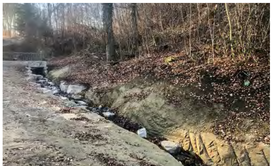
Abb. 4: Die komplette Öffnung des Rainbächlis konnte durch Beiträge des Ökofonds der BKW erreicht werden.
